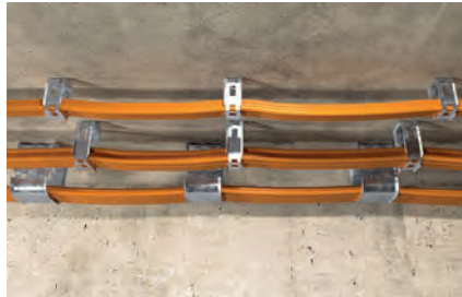
Kabelbefestigung an der Decke
