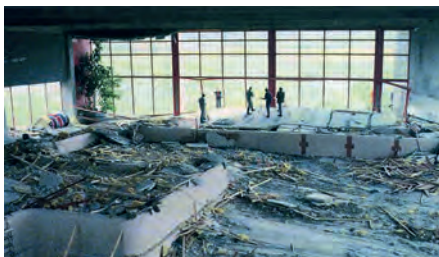
1985 versagte die abgehängte Betondecke eines Hallenbades im schweizerischen Uster. Die Aufhängungen der Decke aus nichtrostendem Stahl A2 zeigten rein äußerlich keinerlei Mängel, waren jedoch innerlich teilweise vollkommen durch Spannungsrissskorrosion zerstört.
