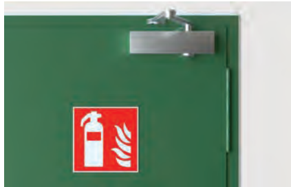
Verfugungen an Brandschutztüren
