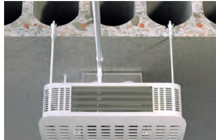
Klimageräte in Spannbeton-Hohldeckenplatten
