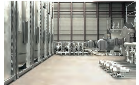
Chemie-Produktion mit Silos und Rohrleitungen
