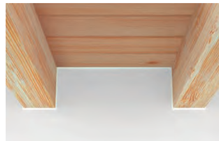
Dehnfugen im Innenbereich
