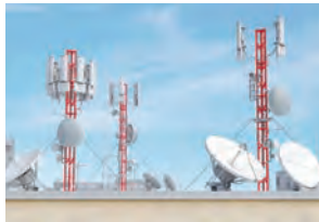
Antennen und Masten
