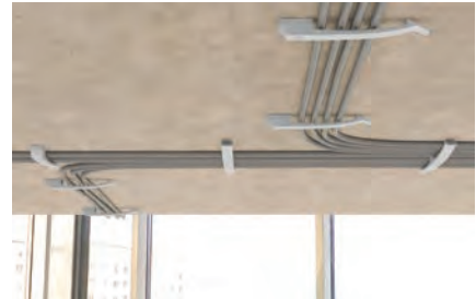
Befestigung von Kabelsträngen
