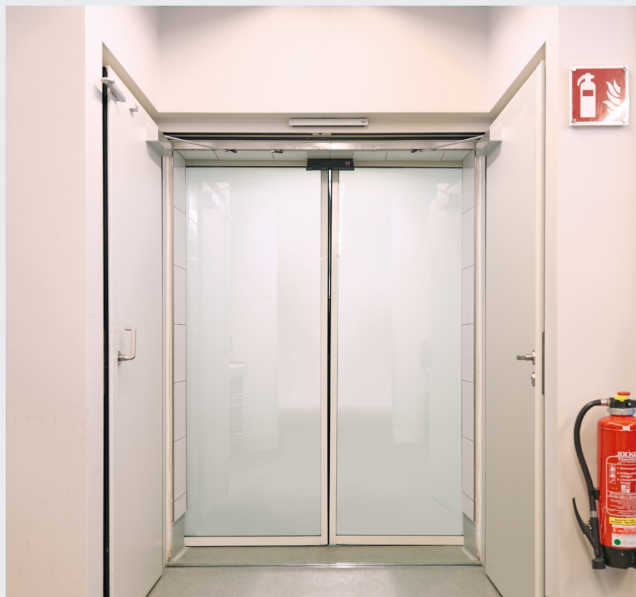
Ansichtsseite Feuer- und Rauchschutztür (Tagbetrieb)
